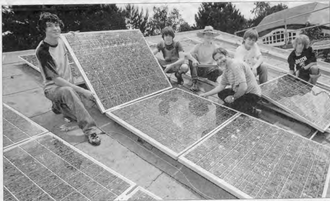
Julian Dehs, Robin Deising, Ruben Maurer, Ulrich Fuchs, Joost Römer und Daniel Frieling (v.l.) gehören zu den Helfern, die die Photovoltaik-Anlage auf dem Cafeteria-Dach installiert haben. Foto: t & w
